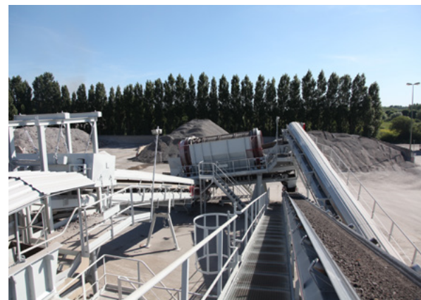
©Eurovia SMC : Installation de traitement des mâchefer
